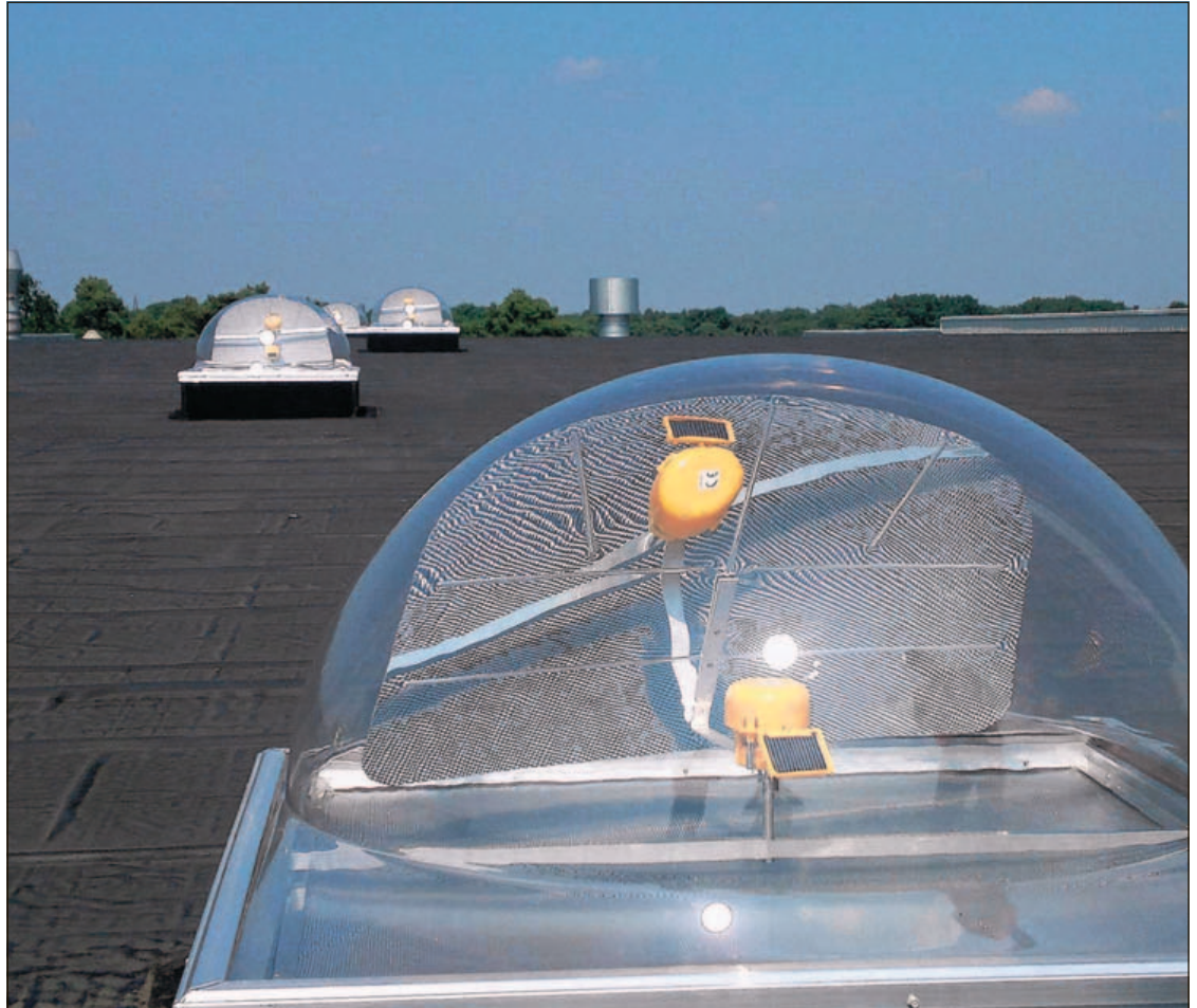
■ Lichtkoepels op het dak van Kingspan Unidek.
